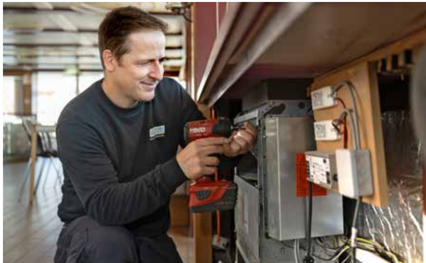
Christian Dütschler Projektleiter Kleinanlagenbau und Unterhalt für Heizungs-, Lüftungs- und Klimaanlage.
